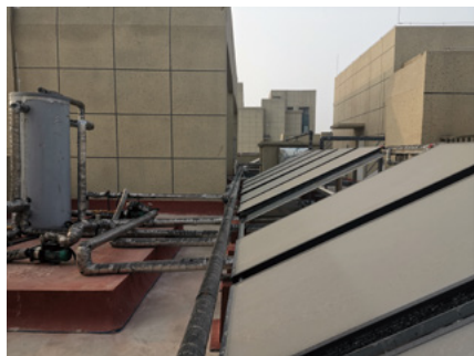
◎ 太原海德公园项目利用大楼屋顶闲散空间建设太阳能热水系统
