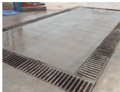
◎ 车辆清洗污水收集槽
