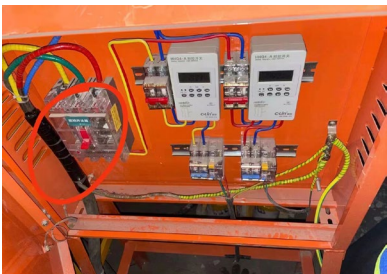
项目生活区采用限时控电器
